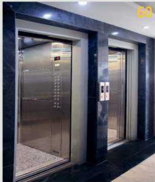
59-60 نام پروژه: مجتمع مسکونی دراک کارفرما: شرکت سرمایه گذاری مسکن جنوب نوع آسانسور: کششی سال ساخت: ۱۳۹۶ تعداد: ۷ دستگاه
