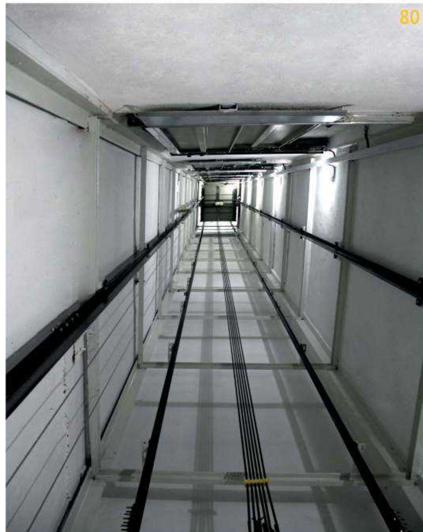
80 PROJECT NAME: MINIATURE RESIDENTIAL COMPLEX CLIENT: MOHAMMADRAZI PEYRO ELEVATOR TYPE: TRACTION YEAR OF CONSTRUCTION: 2019 / 2020 NUMBER: 1 ELEVATOR ۸۰ نام پروژه: مجتمع مسکونی مینیاتور ۲ کارفرما: محمدرزی پیرو نوع آسانسور: کششی سال ساخت: ۱۳۹۸ تعداد: ۱ دستگاه
